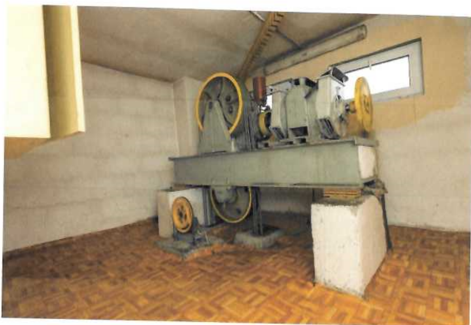
Fot 12. Wnętrze maszynowni
