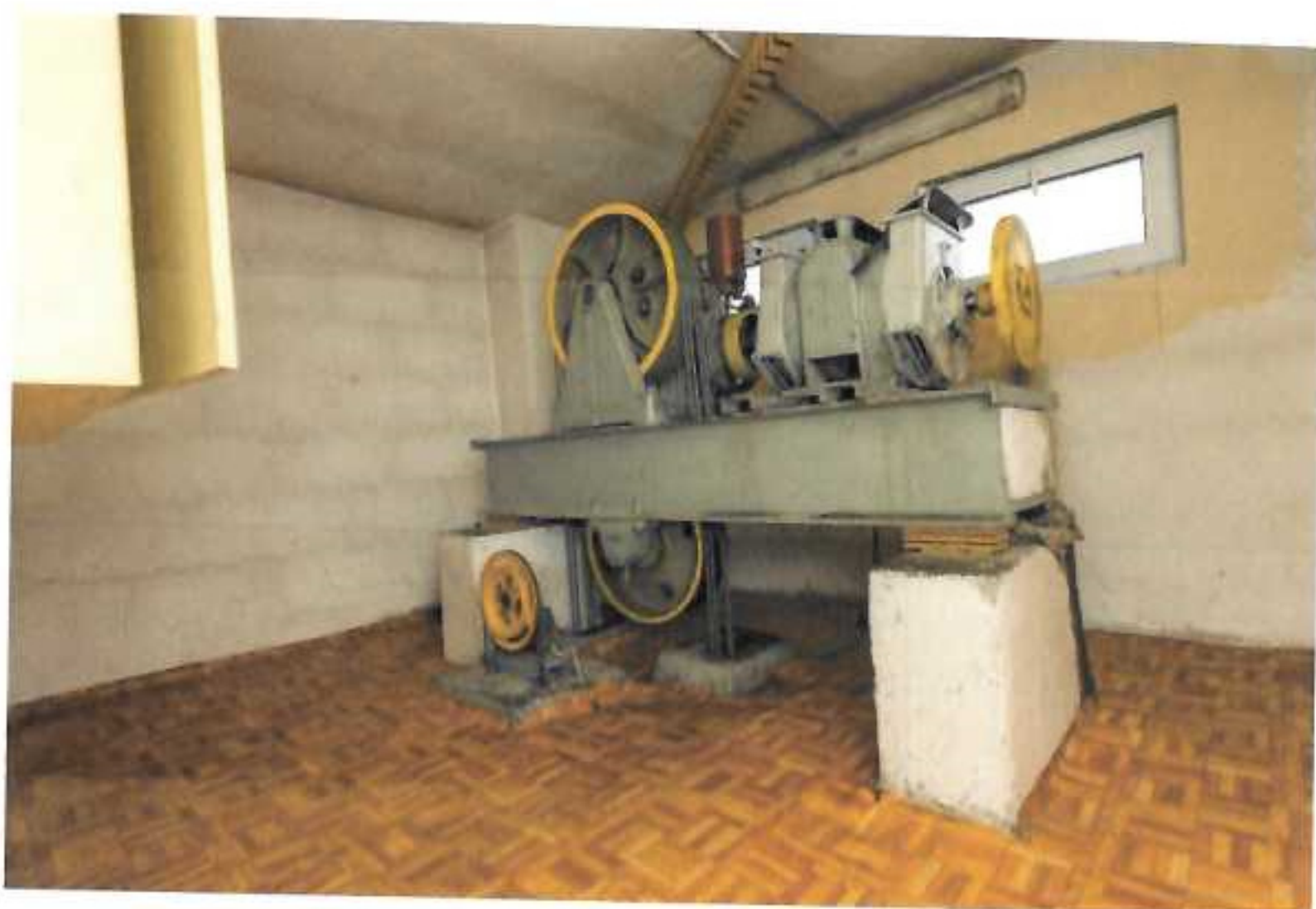
Fot 12. Wnętrze maszynowni
